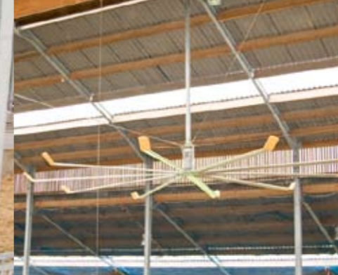
Ventilatoren verfrissen op warme dagen
